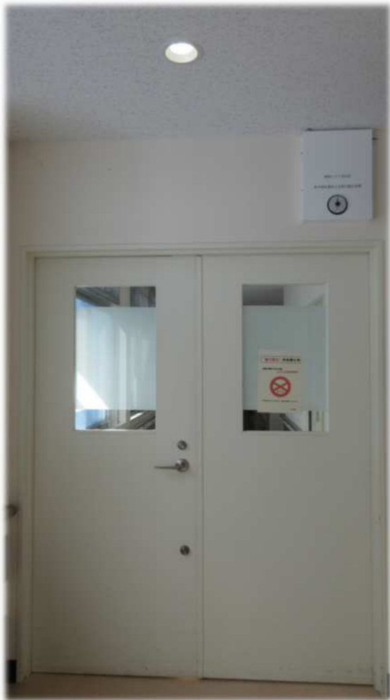
感染エリア入口に設置された差圧計
